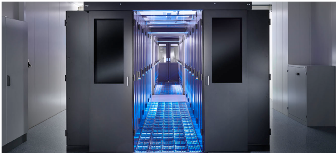
Kältegang im Rechenzentrum
